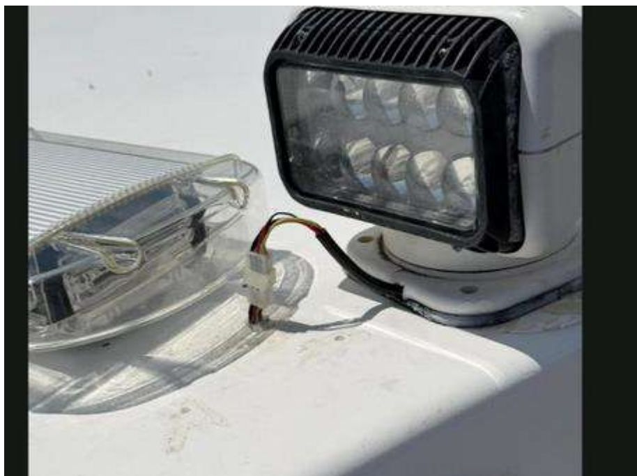
Figura 1. Conector eléctrico del faro de búsqueda 360° expuesto sin protección sellada.
