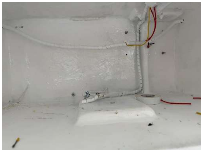
Instalación eléctrica interna
