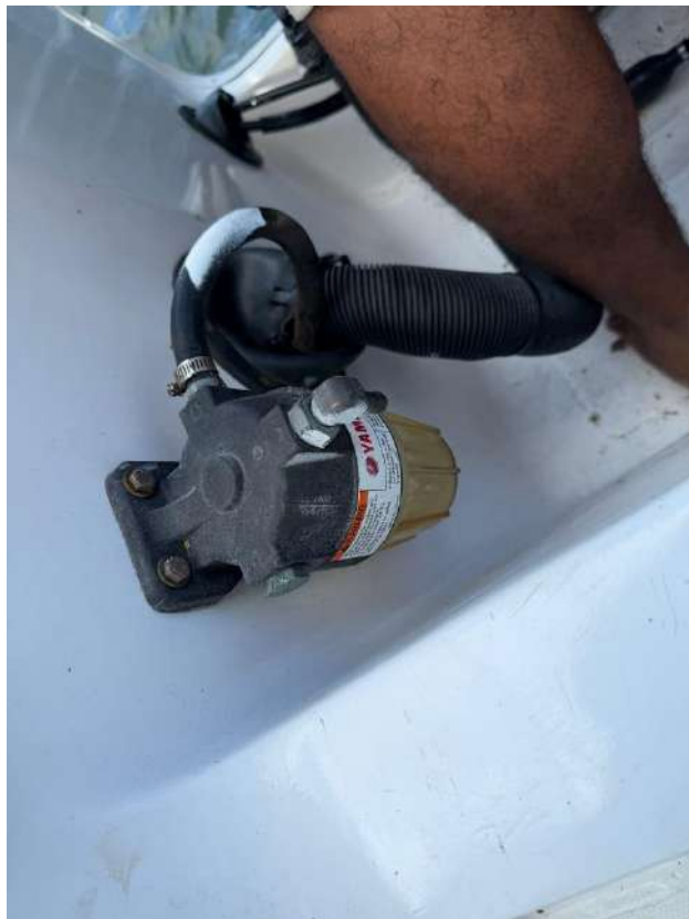
Sistema de bombas y acceso a compartimiento interno
