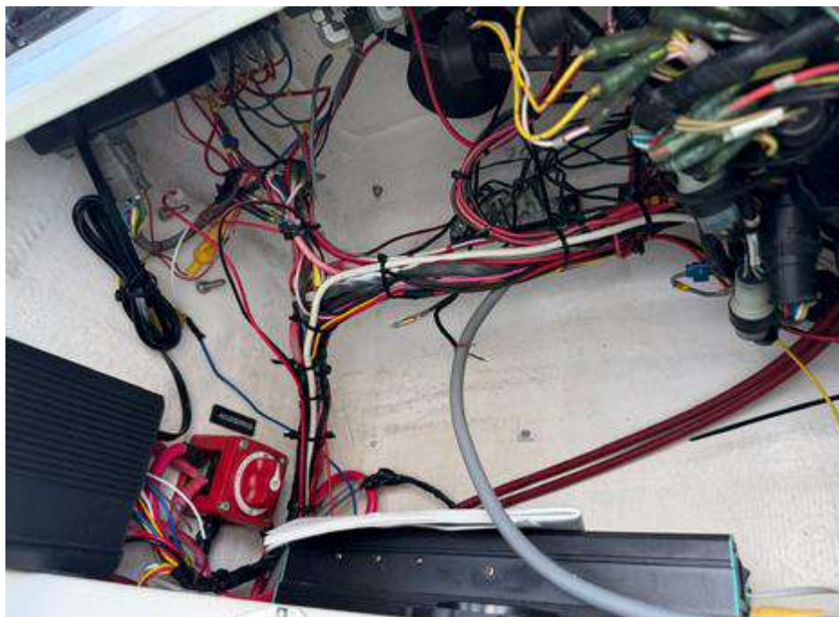
Figura 5. Compartimento eléctrico de la consola — conductores sin arnés organizado, sin funda protectora y sin separación funcional de circuitos.
