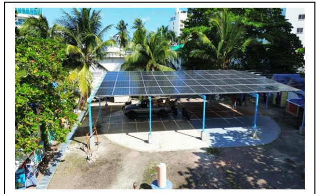
Paneles Solares Instalados en la Secretaría de Turismo
