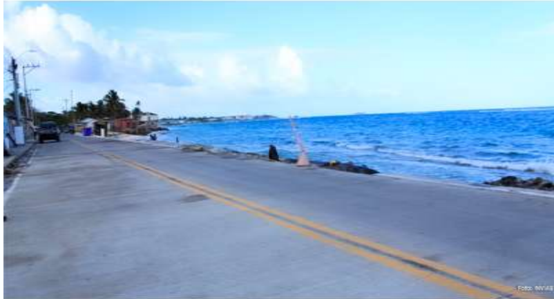
Ilustración 11. Recuperación de vías en la circunvalar tras el huracán Iota.
